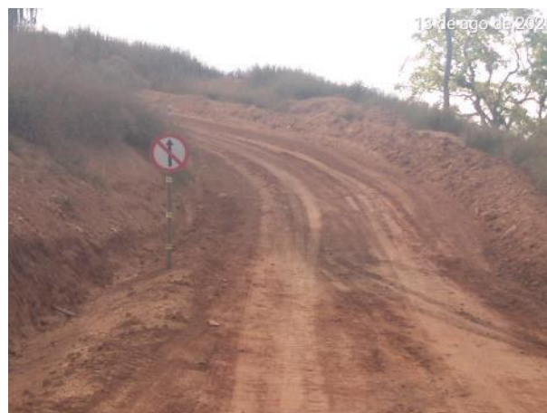
Foto 243 – Sinalização de sentido proibido na margem esquerda. (Data:13/08/2020)
