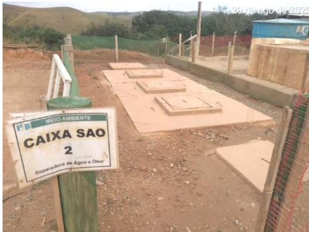
Foto 306 – Caixa SAO 2 na área de manutenção no canteiro operacional. (Data:20/08/2020)
