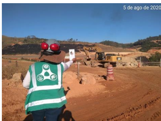
Foto 342 – Monitoramento de fumaça preta em equipamento. (Data:05/08/2020)
