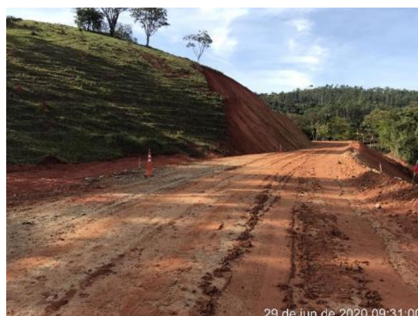
Foto 285 – Inspeção após chuva - MD03. (Data:29/06/2020)
