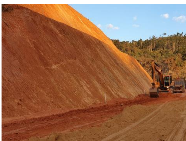
Foto 253 – Talude de corte no acesso da M.D.03. (Data:28/05/2020)
