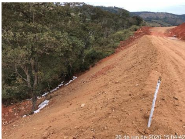
Foto 276 – Inspeção após chuva – MD01. (Data:26/06/2020)
