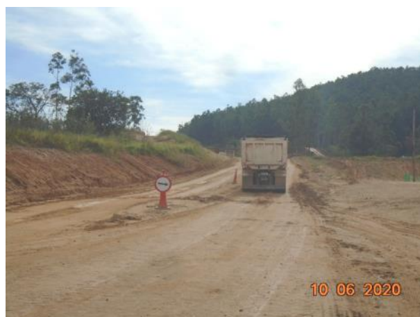
Foto 237 – Sinalização de sentido obrigatório para o acesso a MD03. (Data:10/06/2020)
