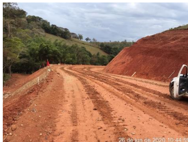
Foto 277 – Inspeção após chuva – MD01. (Data:26/06/2020)
