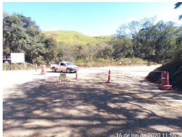
Foto 150 – Bloqueio da via para desmorte de rocha na estrada municipal de Pedreira. (Data:16/06/2020)
