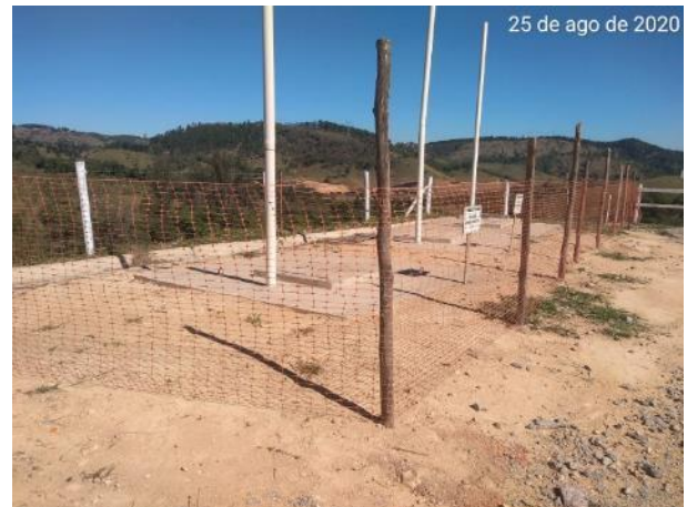
Foto 317 – Sistema de fossa séptica do canteiro operacional. (Data:25/08/2020)
