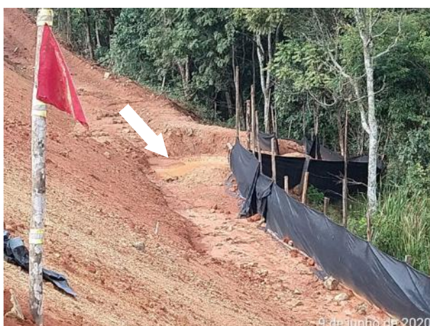
Foto 258 – Cacimba localizada no desvio MD03 e dispositivo de contenção ambiental. (Data:09/06/2020)
