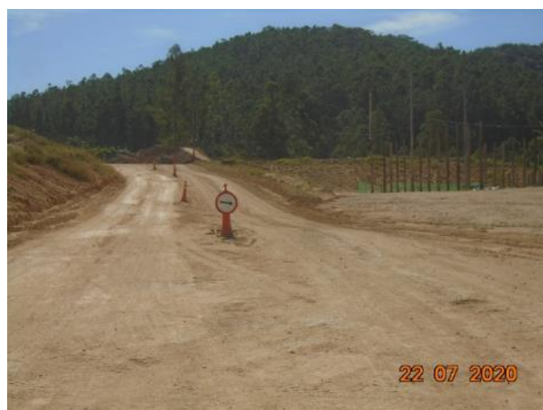
Foto 241 – Sinalização de sentido obrigatório. (Data:22/07/2020)
