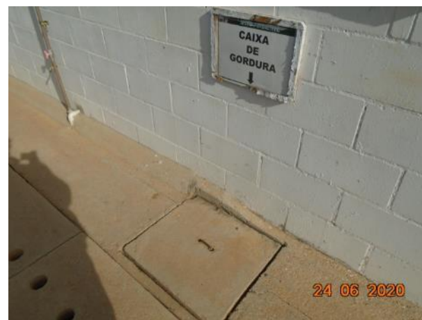
Foto 303 – Caixa de gordura refeitório do canteiro operacional. (Data:24/06/2020)
