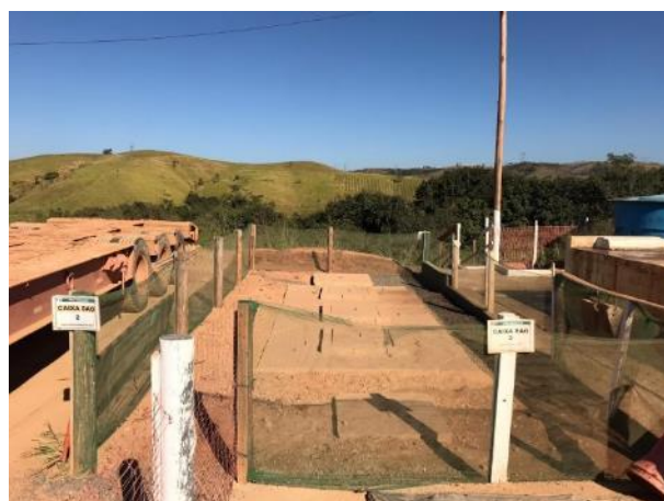
Foto 301 – Registro da caixa SAO 2 na área da manutenção no canteiro operacional. (Data:28/05/2020)
