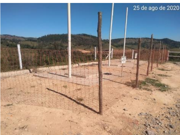
Foto 322 – Sistema de fossa séptica do canteiro operacional. (Data:25/08/2020)
