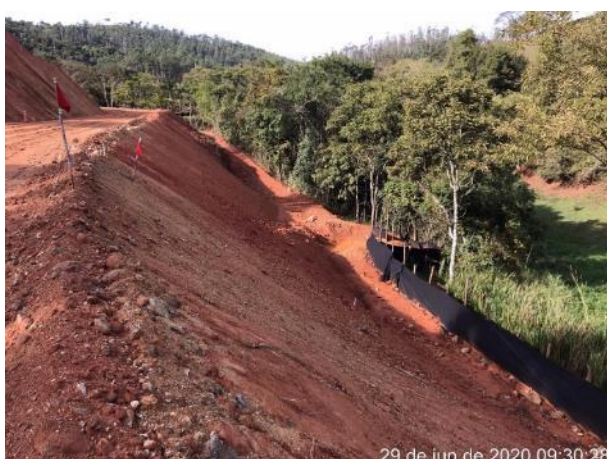
Foto 284 – Inspeção após chuva - MD03. (Data:29/06/2020)
