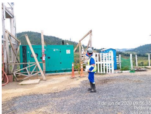
Foto 338 – Monitoramento de fumaça preta em gerador. (Data:09/06/2020)
