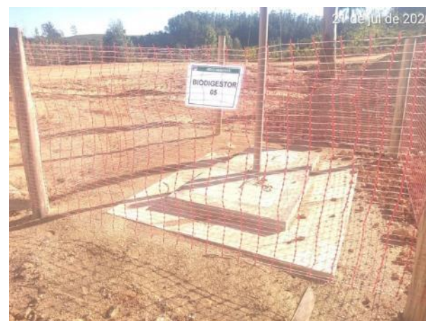
Foto 321 – Biodigestor 05 do canteiro operacional. (Data:21/07/2020)
