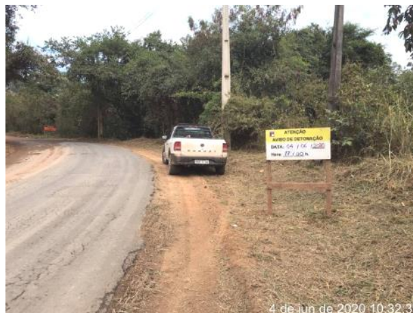
Foto 147 – Placa informativa sobre a atividade de desmonte de rocha na estrada municipal de Pedreira. (Data:04/06/2020)
