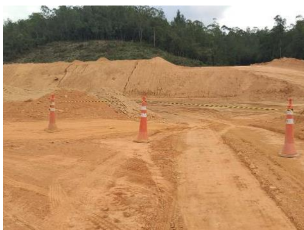
Foto 232 – Sinalização de cones nas obras de acesso ao bota fora II M.E. (Data:15/05/2020)
