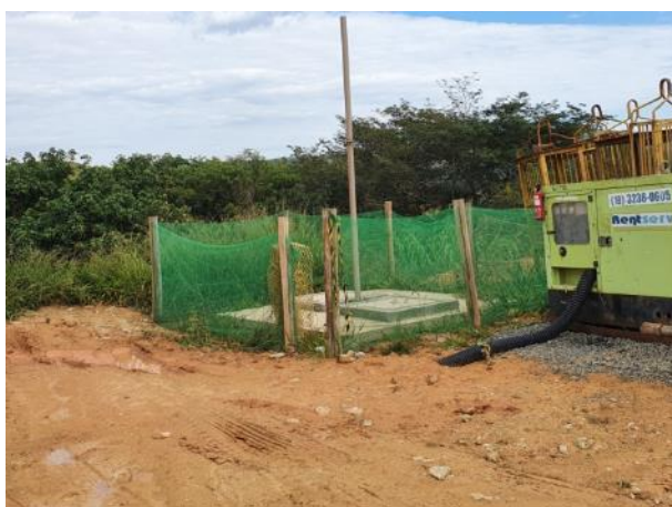
Foto 320 – Biodigestor 04 no patio de mecânica. (Data:04/06/2020)
