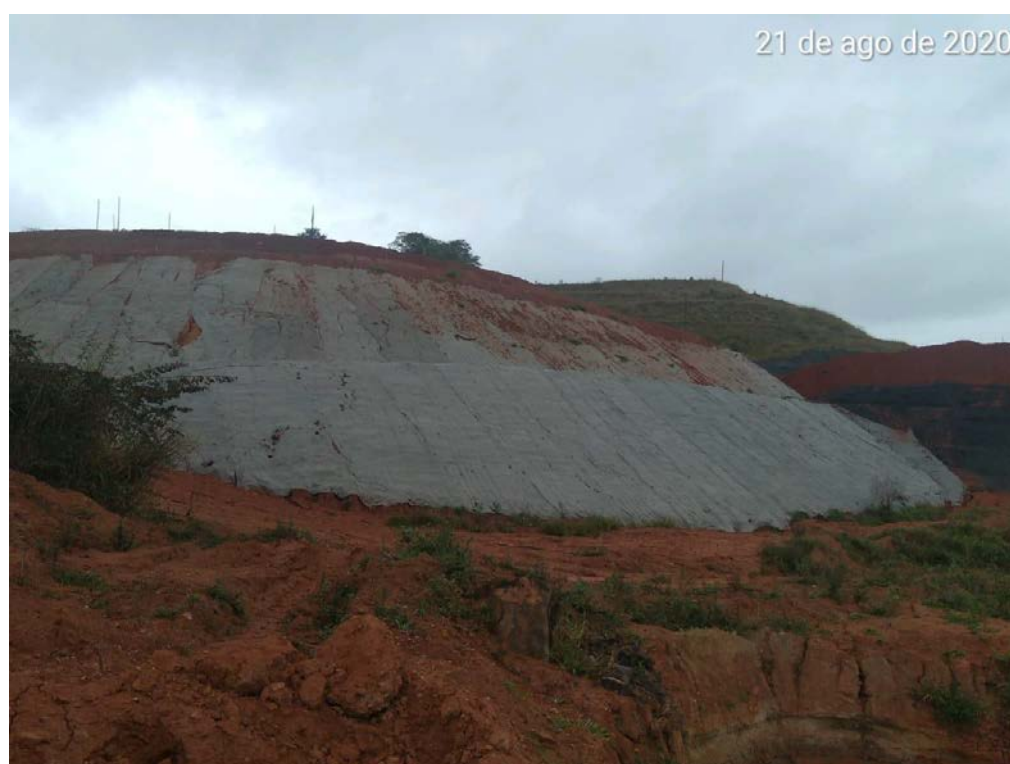
Foto 393 – Bota-Espera espaldar – Margem Direita. (Data:21/08/2020)
