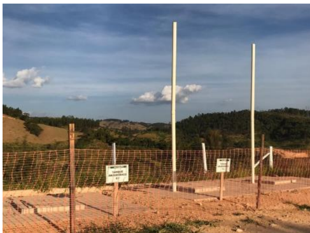
Foto 318 – Sistema de tratamento de efluente do canteiro operacional. (Data:11/05/2020)
