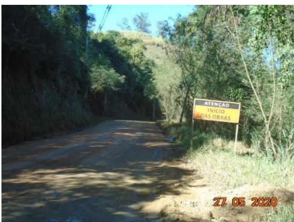
Foto 216 – Sinalização implantada de início das obras na estrada municipal de Pedreira. (Data:27/05/2020)
