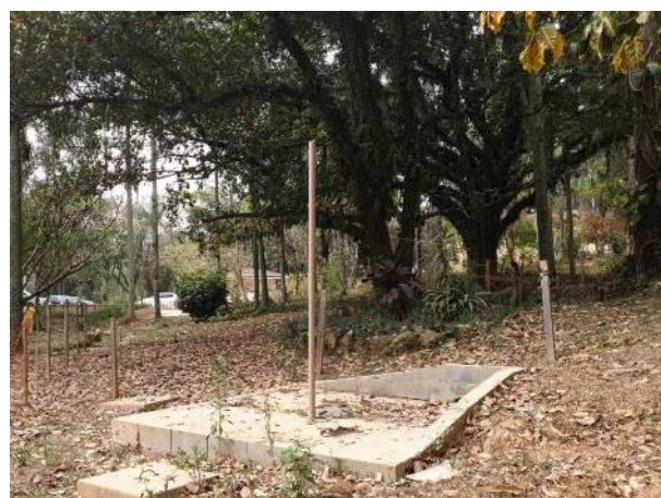
Foto 323 – Biodigestor 02 – canteiro administrativo. (Data:25/08/2020)
