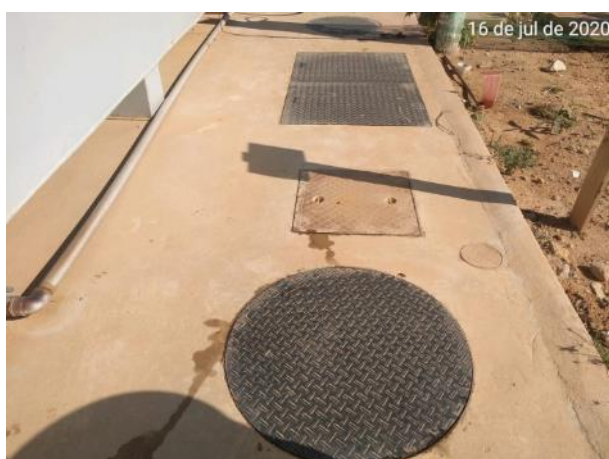
Foto 304 – Caixa SAO 1 na área de abastecimento. (Data:16/07/2020)
