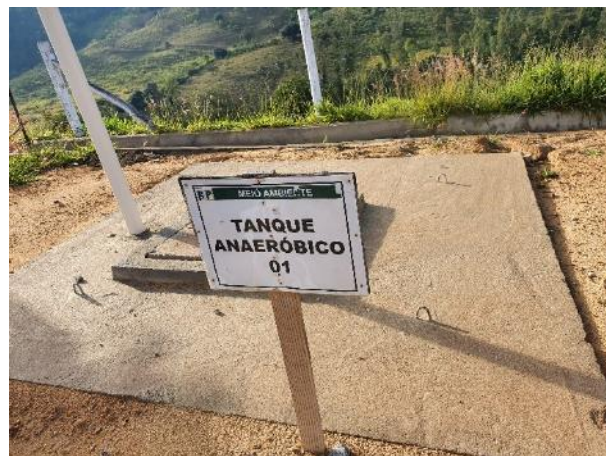
Foto 319 – Tanque anaeróbico 01 do canteiro operacional. (Data:04/06/2020)
