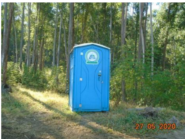
Foto 308 – Banheiro químico instalado na frente de serviço no acesso a MD03. (Data:27/05/2020)
